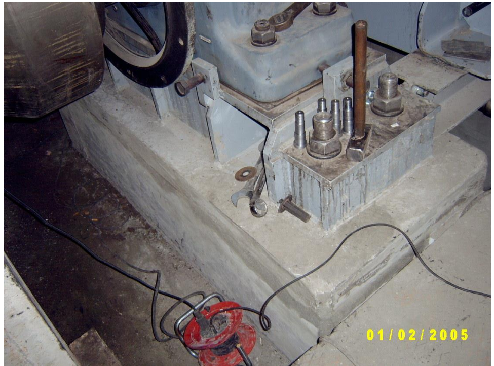
SANACIJA LEŽIŠČ MLINA ZA CEMENT, SALONIT ANHOVO
