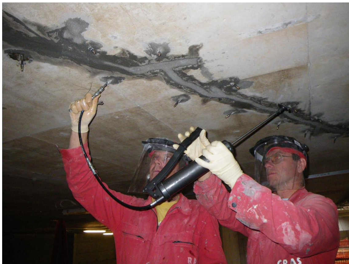
SANACIJA RAZPOK V KROVNI PLOŠČI, GH KONGRESNI TRG, LJUBLJANA
