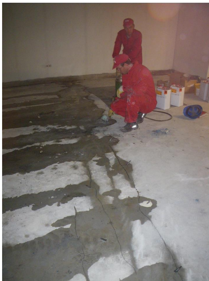
SANACIJA VTEKANJA SKOZI TALNO PLOŠČO, GH KONGRESNI TRG, LJUBLJANA
