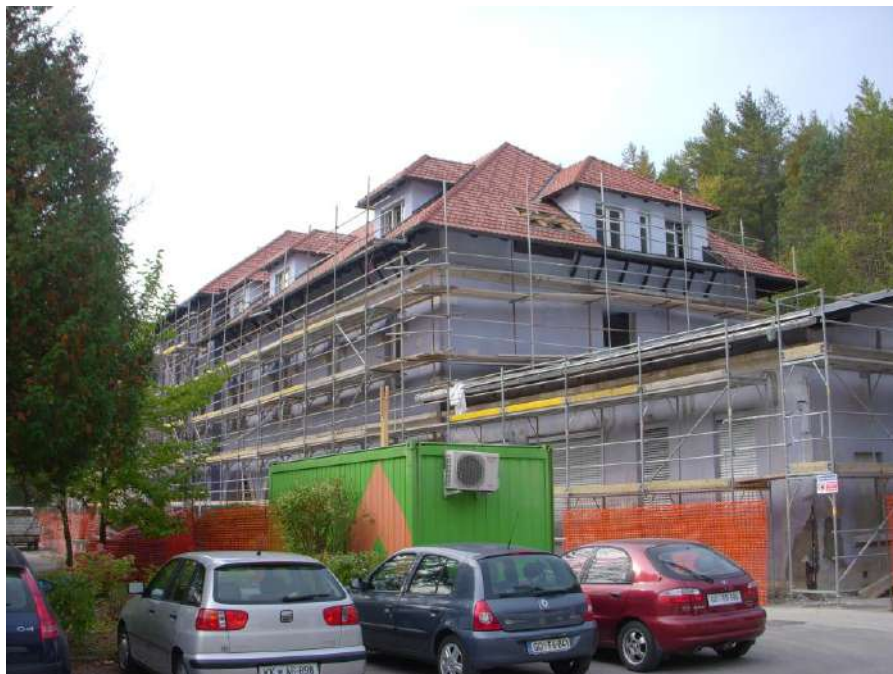
SANACIJA VLAGE, BOLNIŠNICA IDRIJA
