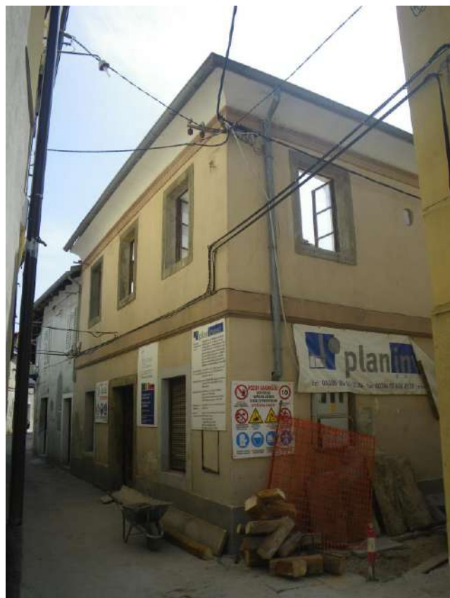
STATIČNA UTRDITEV IN SANACIJA VLAGE, CENTER KOLARSKA 10, KOPER
