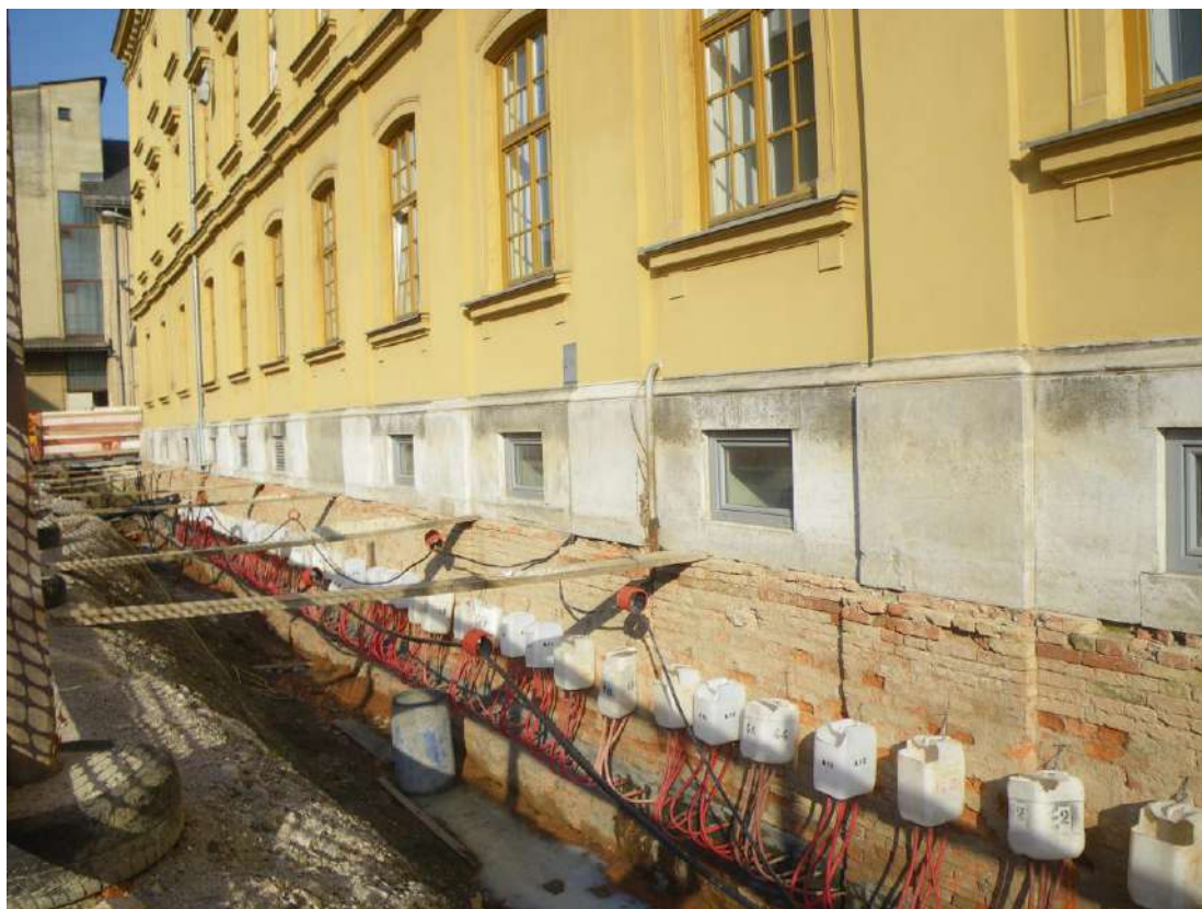
SANACIJA VLAGE, OBJEKT ARHIV, TOBAČNA LJUBLJANA
