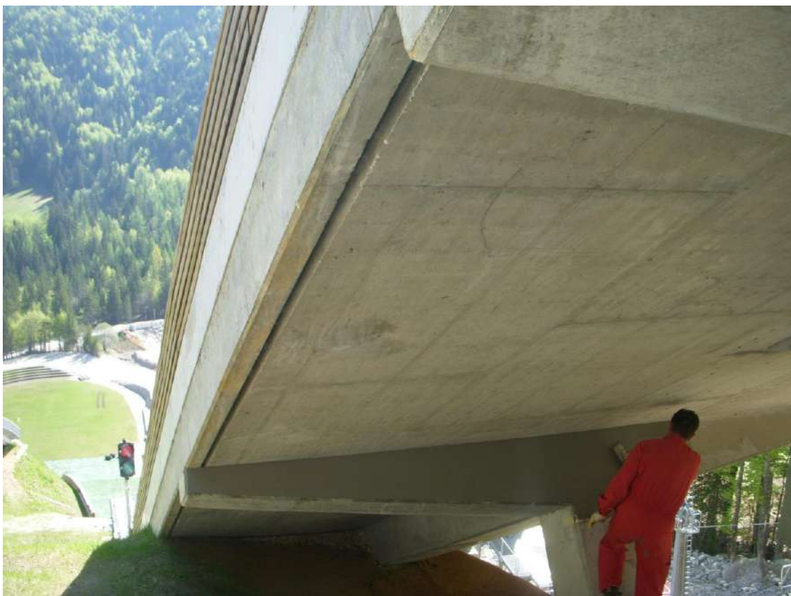
SANACIJA POŠKODB IN ZAMAKANJ NA OBJEKTIH NORDIJSKEGA CENTRA, PLANICA
